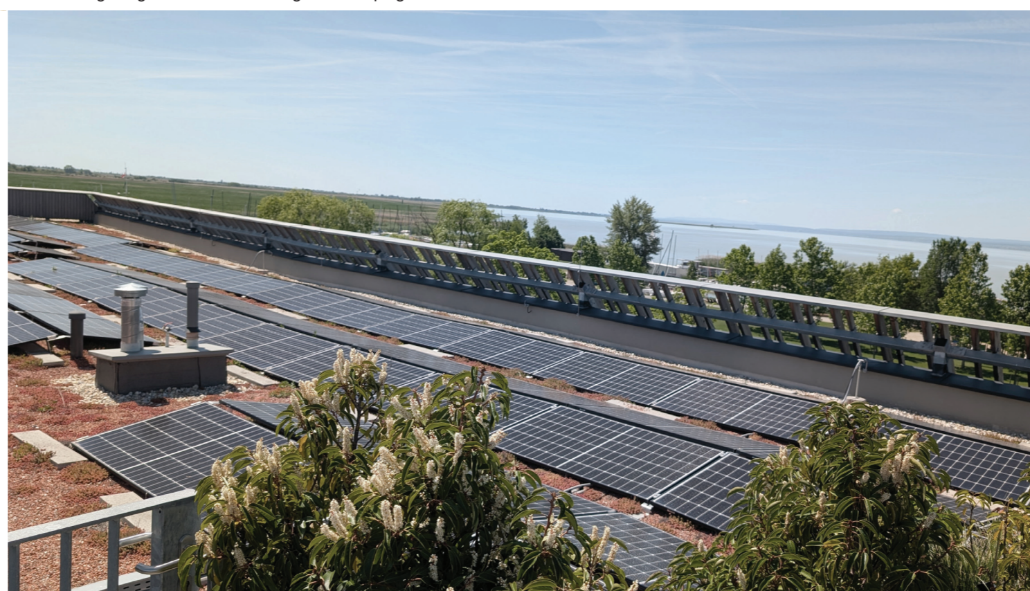
Abb.: Flach geneigte Photovoltaik Anlage mit entspiegelter Oberfläche
